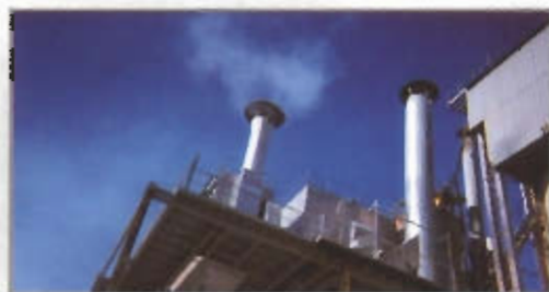
Installation Filtrage pour Séchage de sépiolite SEPIOLSA (GUADALAJARA-ESPAGNE)
