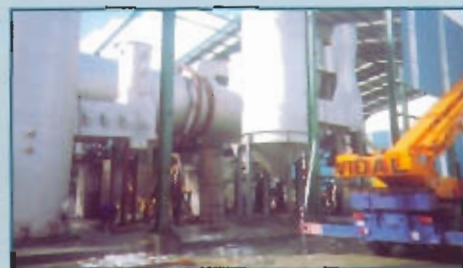
Installation de séchage d'ordures ménagères pour four d'incinération SOGAMA (GALICIA-ESPAGNE)
