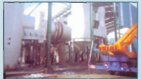
Planta de secado de residuos sólidos para incineradora. SOGAMA (GALICIA-ESPAÑA)
