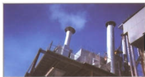
Instalación Filtrado para secado de Sepiolita. SEPTOLSA (GUADALAJARA-ESPAÑA)
