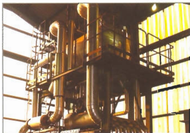
Grupo de Frío. Circuito abierto de Amoniac 2.000.000 Frigorías FERTIBERIA (BILBAO-ESPAÑA).
