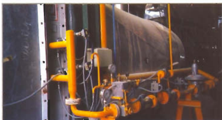
Cámara de Combustión de Vena de Aire. PLANTA DE GUBRE-TURQUIA
