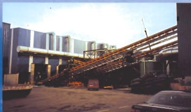
Cintas de transporte de materia orgánica a la zona de secado.
