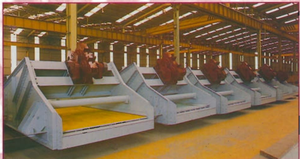
6 cribles horizontaux 2.000 x 6000 mm. Mine de phosphate Gafsa - TUNISIE
