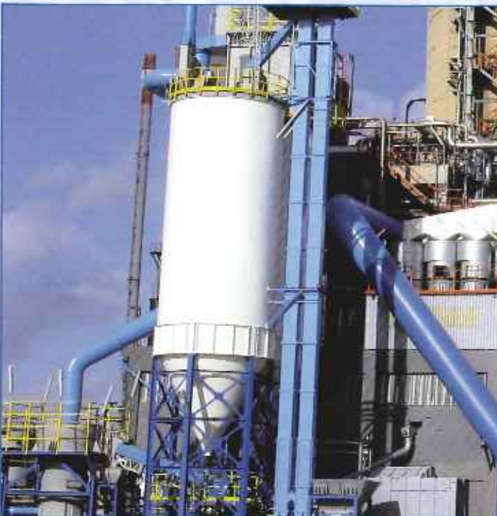
Silos y elevador de cangilones: FERTIAL (Annaba, Argelia) Dolomita.
