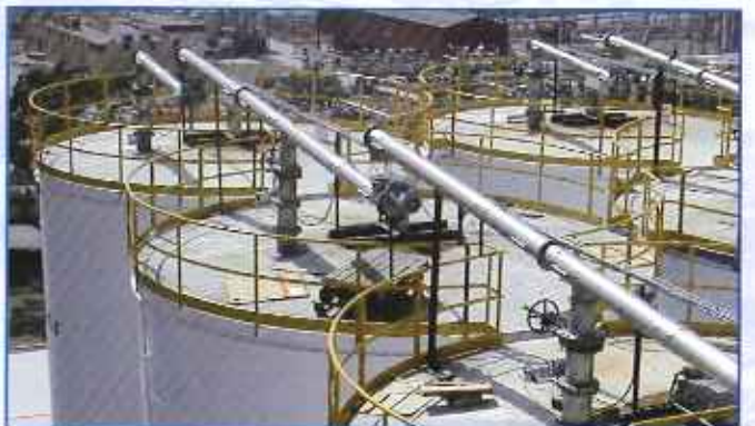
Transportadores sinfin y silos: FOSFATOS DE CARTAGENA (Escombreras, España) Fosfato mono y bicálcico.
