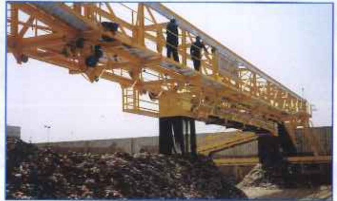
Pórtico cargador con cinta reversible y móvil: DRAGADOS TIR MADRID (Madrid, España) Residuos Urbanos.
