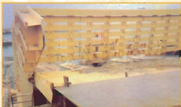
Instalación de 5 "dedos vibrantes" Caudal 1.500 T/h Corte opcional entre 400 a 900 mm "todo uno 0- 2.000 mm" Instalación Presa - COLOMBIA
