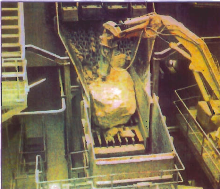
Extractor - Precribador 2.500 x 10.000 mm Caudal 1.500 T/h de 0 - 1.300 mm Corte 250 mm. Detalle del "martillo rompedor" SOLVAY - FRANCIA
