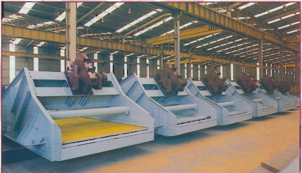
6 cribas horizontales 2.000 x 6.000 mm. Mina de fosfato GAUSA - TÚNEZ
