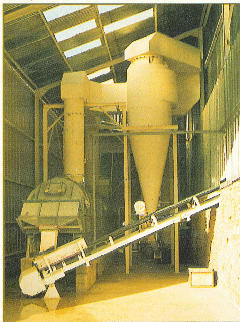
Installation pour le Séchage des Grains de Café - Nestlé - Suisse
