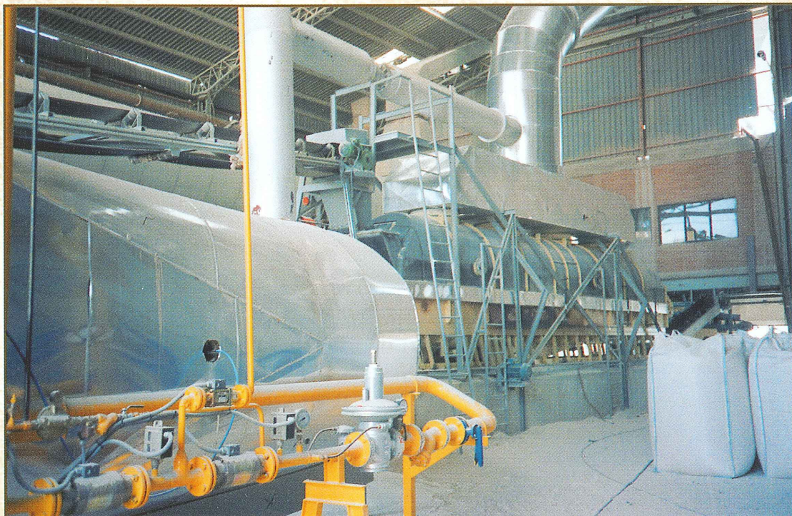
Lit Fluidisé-Haute Temperature pour le séchage d'argile-sepiolite (400° C)
