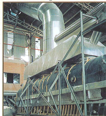
Lecho Fluido Vibrante para tratamiento de arcillas en cogeneración
