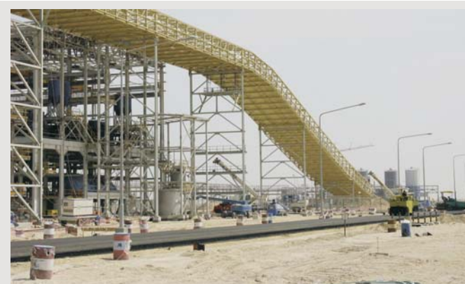
Bandes transporteuses (1.300 T/h), alimentant du phosphate dans l'usine d'acide phosphorique de MA'ADEN/WORLEY PARSONS (Arabie Saoudite). Ingénierie LITWIN.
