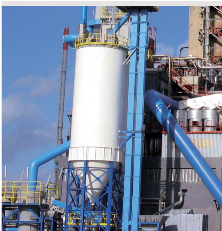
Silos et élévateurs à godets: FERTIAL (Annaba, Algérie). Dolomite.
