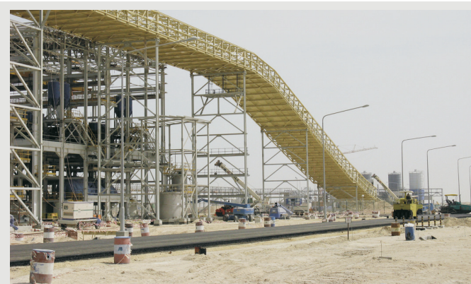
Cintas transportadoras (1.300 T/h) , alimentando en la fábrica de ácido fosfórico de MA'ADEN/WORLEY PARSONS en Arabia Saudita. Ingeniería LITWIN.
