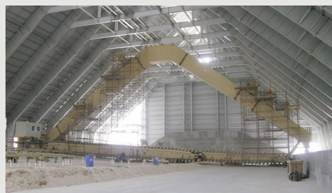
Pórtico rascador del parque de almacenamiento cubierto de fosfato y de aditivos de 21.300 m 2 y 160.000 T para todo el complejo químico de Ras Az Zawr. Cliente: MA'ADEN/WORLEY PARSONS – Ingeniería: LITWIN.
