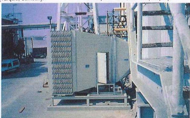
NPK, refroidissement, 1.200.000 frig/h. Fertiberia, Huelva (Espagne).
