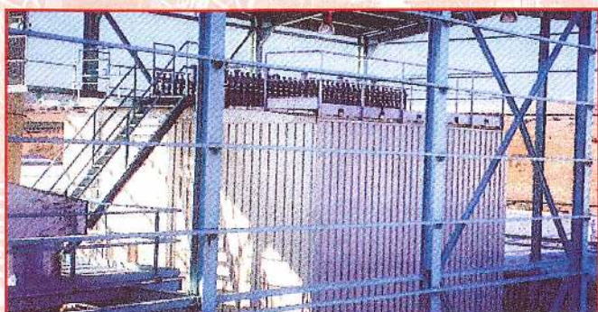
Filtre à manches "jet" 160-2L-10, Sècheur + Granulateur + Refroidisseur d'engrais, NPK. Inabonos (Espagne).
