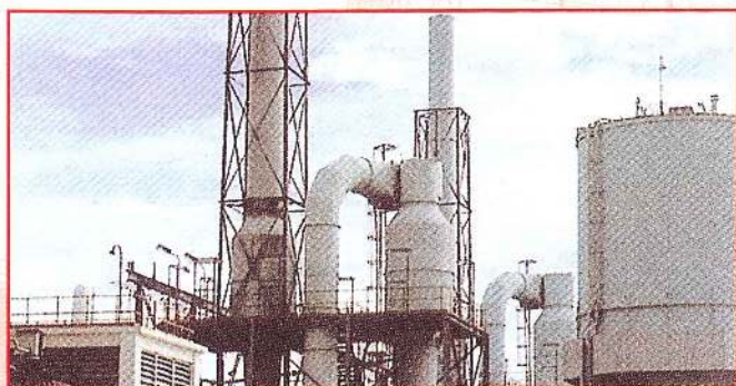
Dépolluissage par "air-mix", 100.000 kg/h, air pour sècheur de sulfate d'ammonium. E.I. Aragonesas (Espagne).
